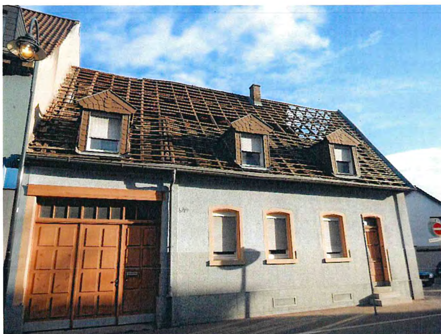
Foto 3 Älteres, baufälliges Wohnhaus mit abge- decktem Dach (Mann- heimer Straße 64, Flst.- Nr. 84/3)
