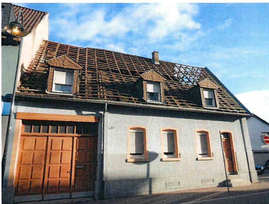
Foto 3 Älteres, baufälliges Wohnhaus mit abge- decktem Dach (Mann- heimer Straße 64, Flst.- Nr. 84/3)
