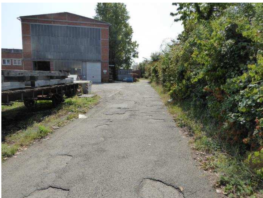
Foto 1: Zustand von Flurstück 355/17 (rechter, westli- cher Bildrand) im Som- mer 2018, Blick nach Süden.
