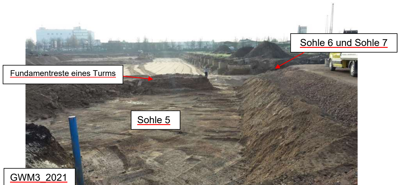
Abb. 4-1 Blick über die Baugrube auf die südliche Teilfläche des neuen Platzes, zwischen dem Gebäude „Farb- und Lösemittelager“ und den Fundamenten der „Montagehalle“ mit Beprobungsfeld „Sohle 5“. Feld „Sohle 6“ und Feld „Sohle 7“ befinden sich im Hintergrund (Stand: 09.12.2022).
