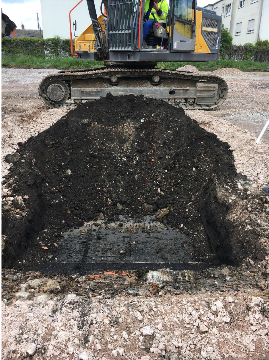
Abb. 4-1 Blick nach Norden, auf den Parkplatz/ehemaliges Sägewerk: Brandschutt, nach Rückbau der Schwarzdecke und unterhalb der Schottertragschicht / Mischprobe MP 1
