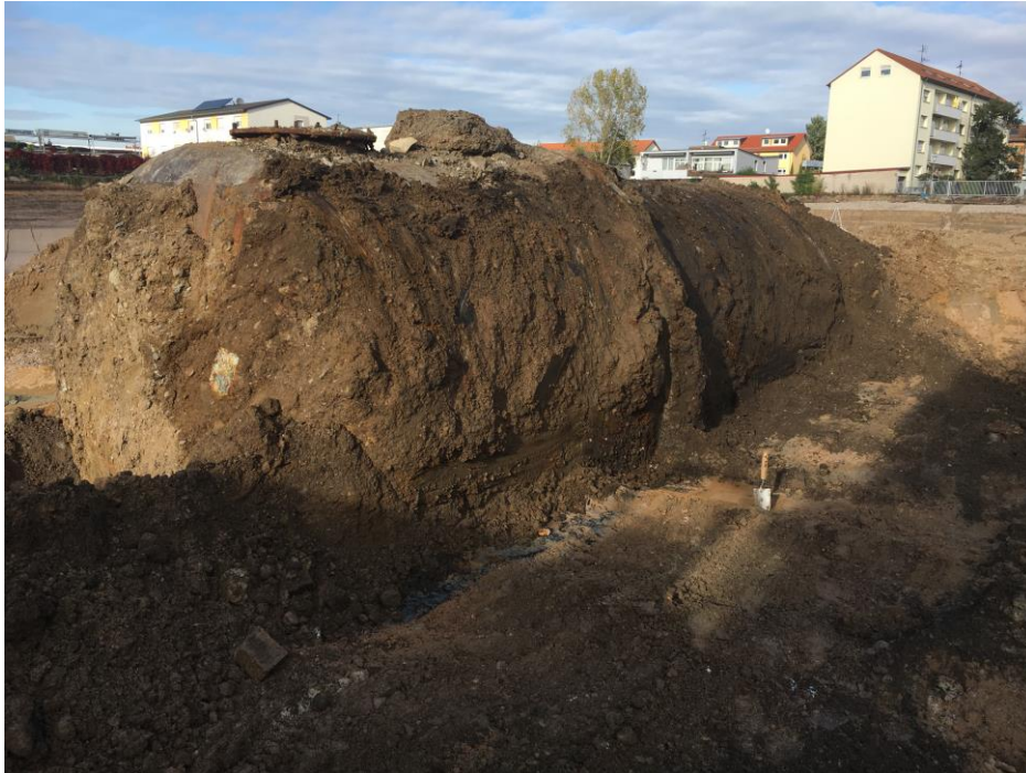
Abb. 4-2 Blick auf den freigelegten Erdtank. Der Tank war seitlich in eine braune, schluffig-sandig-kiesige Auffüllung eingebettet, welche im Bereich des vorderen Domschachtes einen deutlichen MKW-Geruch zeigte. Die Entnahme der Bodenproben zur Beweissicherung erfolgte zu beiden Seiten, vor und, nach der Tank-Bergung, auch unterhalb des Tanks.
